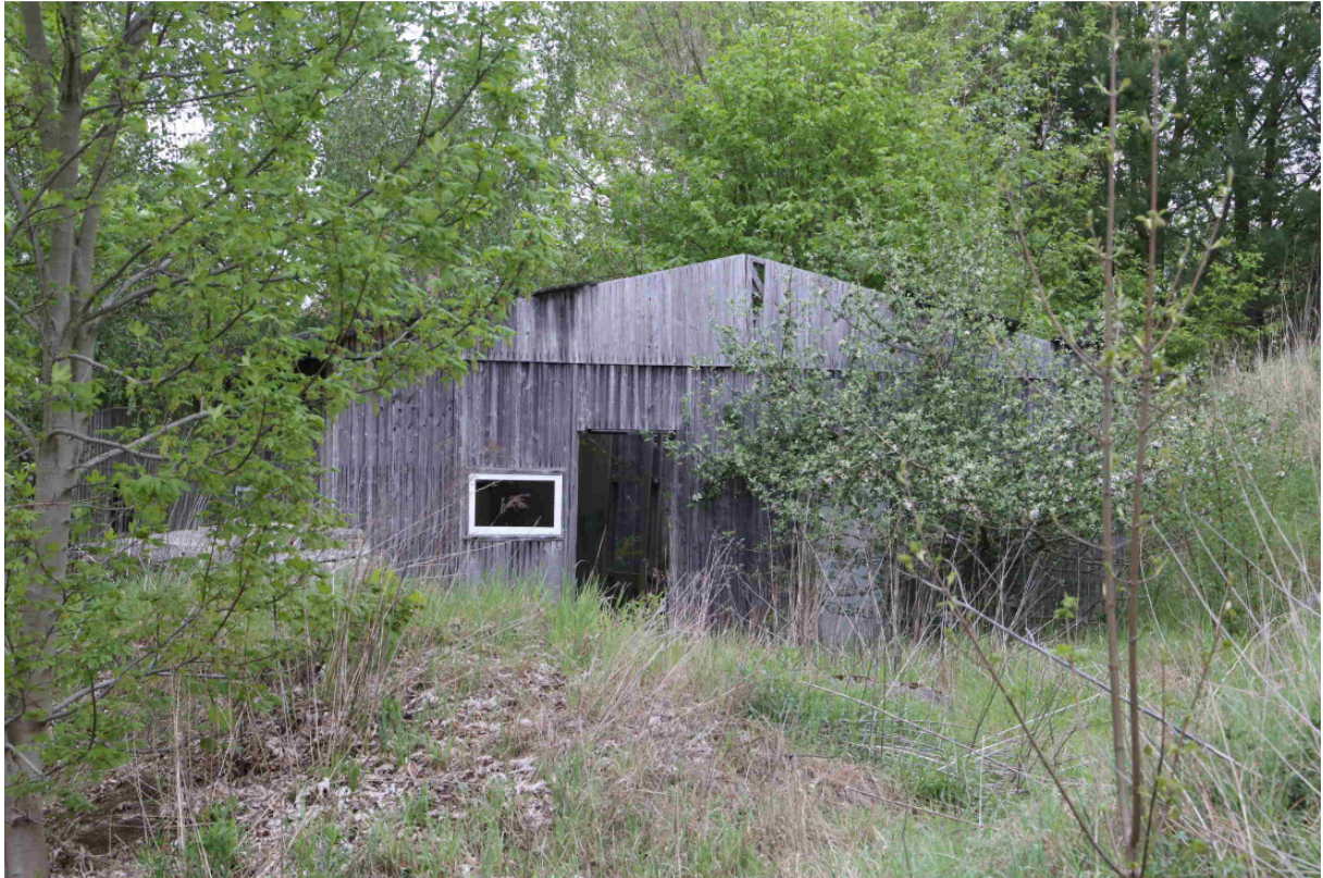
Abbildung 3: zerfallener Holzschuppen im östlichen Gebietsteil
